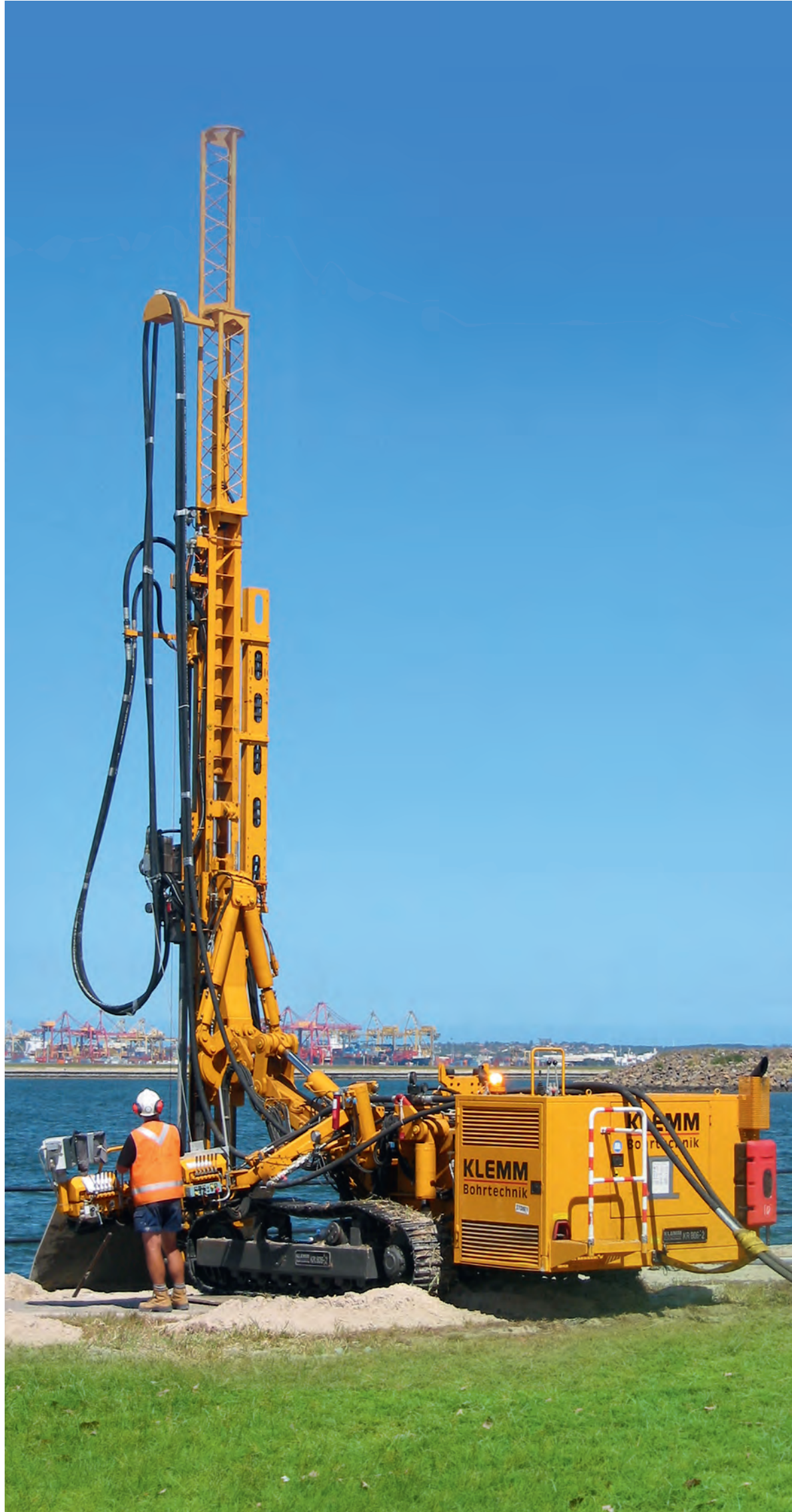
Hochdruckinjektionen High-pressure injections
